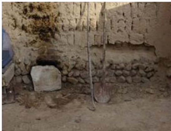
生土墙体墙根部剥蚀削弱
