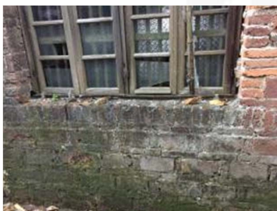
砖墙墙根处碱蚀
