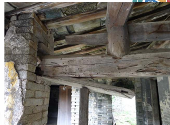
木构件劈裂、局部糟朽
