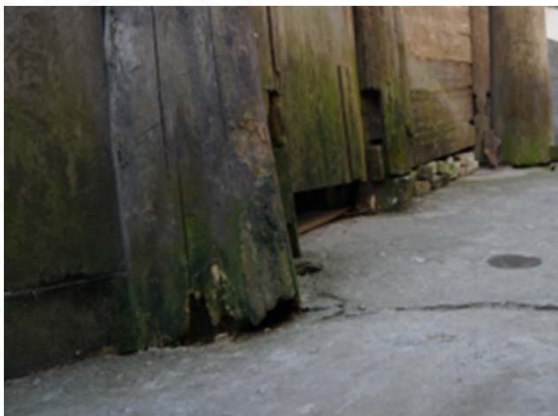
木柱柱脚腐朽
