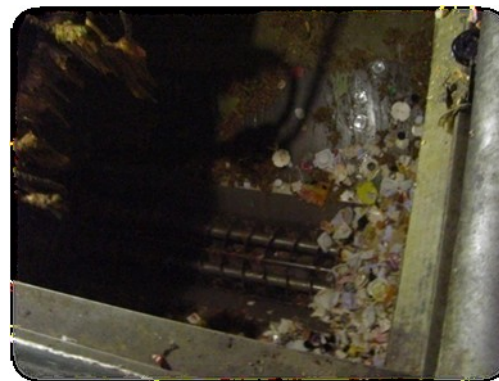
储料槽及螺旋输送机
