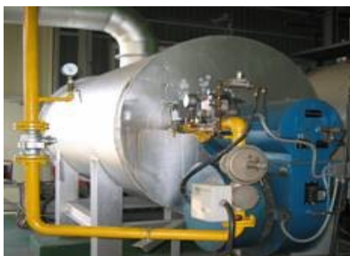
除臭·热源设备
