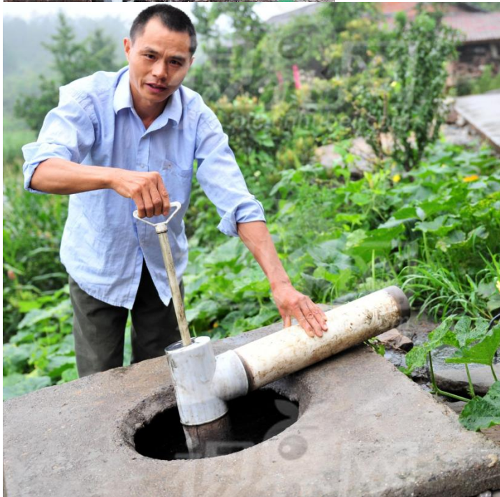
有机垃圾投入沼气池
